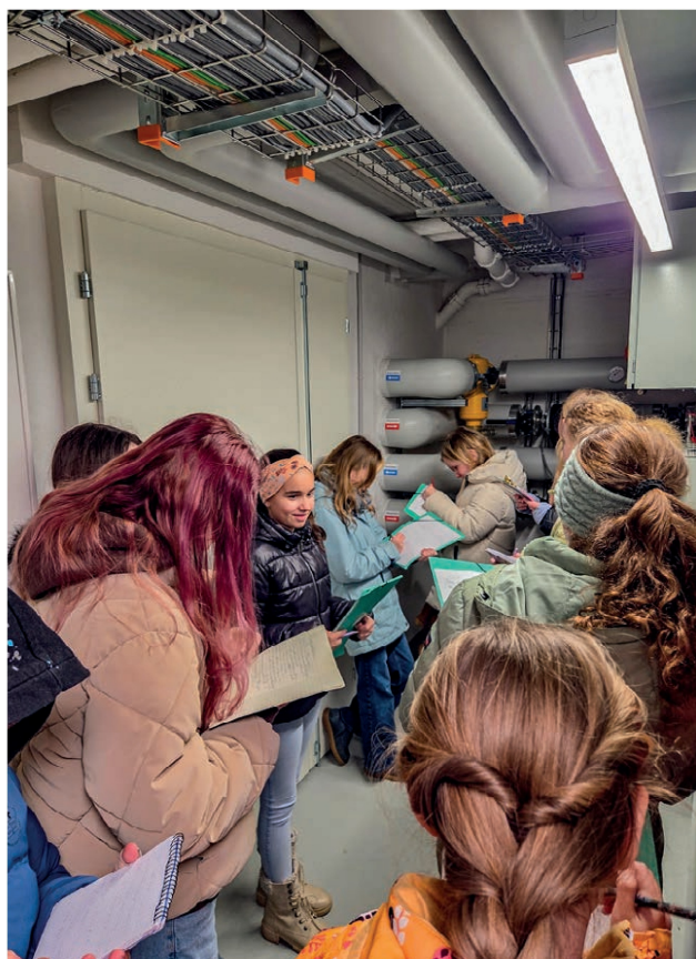
Wir gingen dann auch noch in den Schulhauskeller und konnten sehen, wo das warme Wasser gemacht wird.
