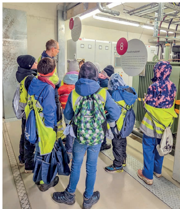
Der vom Kraftwerk produzierte Strom hat 20 000 Volt.
